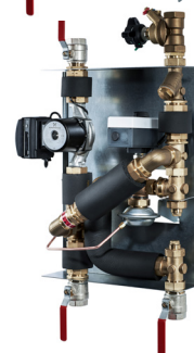
Foto viser shunt system med tilslutning for direkte anlæg
