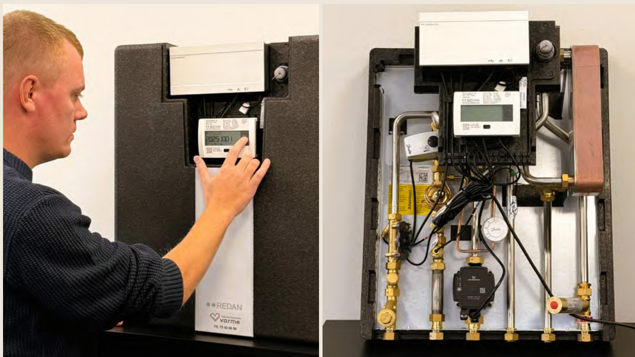
Fjernvarmeselskabet har investeret i mere avancerede units med tilhørende energimålere for at sikre, at Sønderborg Varme kan servicere sine forbrugere bedre, udvikle digitale løsninger, som giver et bedre indeklima hjemme hos forbrugerne, og på sigt sikre, at forbrugerne sparer penge.
